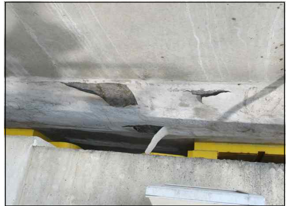
거더 외부 하면 보수재 들뜸(S11)
