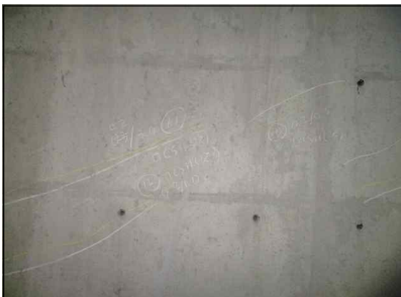
거더 내부 우측면 균열(S11)
