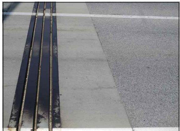
신축이음 후타재 균열(P2)
