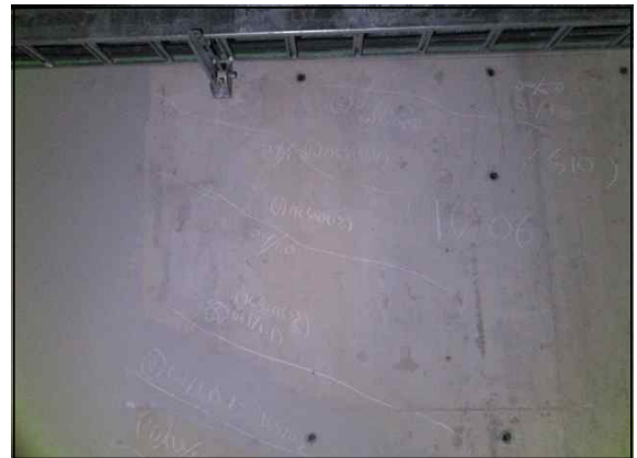
거더 내부 우측면 균열(S10)
