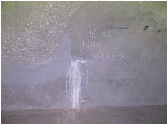
거더 내부 우측면 백태(S4)
