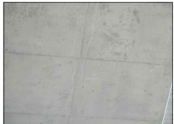
거더 외부 하면 균열(S4)
