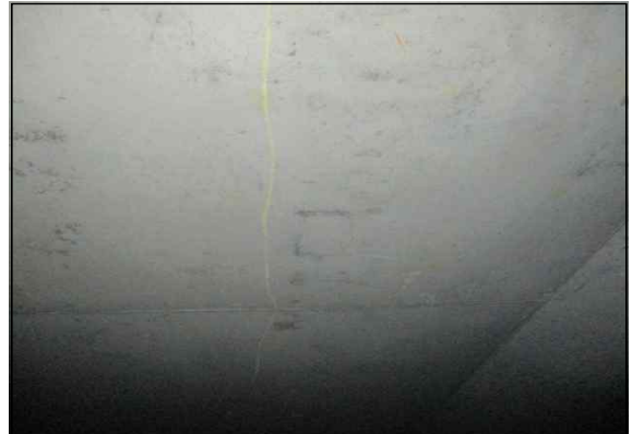
거더 내부 상면 균열(S3)
